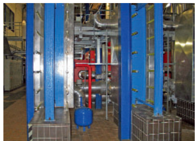
Abb. 3.5 und 3.6 Geothermische Heizzentrale in Neustadt-Glewe; oben: Ölkessel, unten: Wärmeübertrager Thermalfluid/Fernwärmewasser
