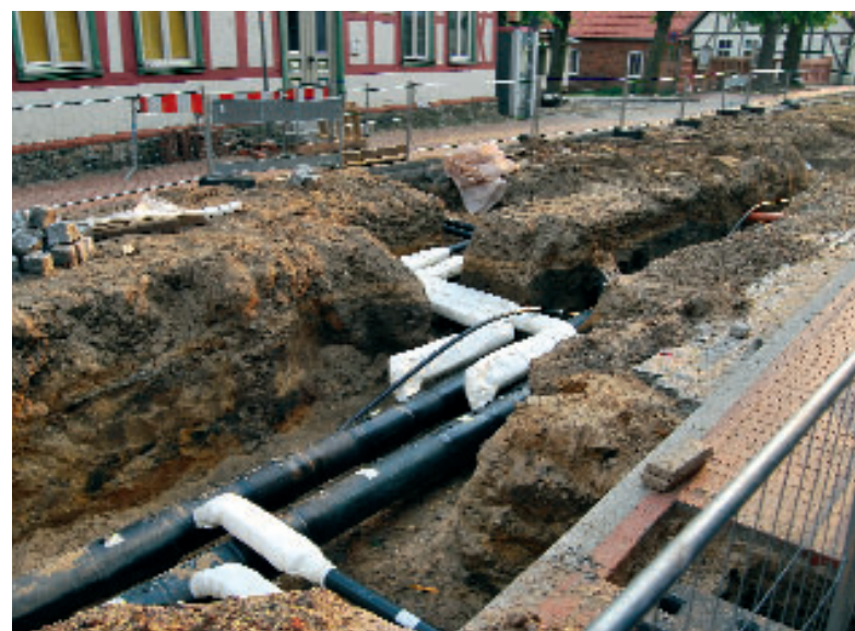
Abb. 3.3 Fernwärmeleitung mit abgehenden Hausanschlüssen
