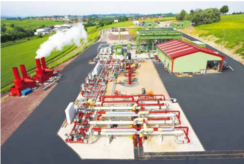
Abb. 17: HDR-Anlage Soultz-sous-Forêts (Quelle: Groupements Européens d'Intérêt Économique (GEIE) „Exploitation Minière de la Chaleur“)
