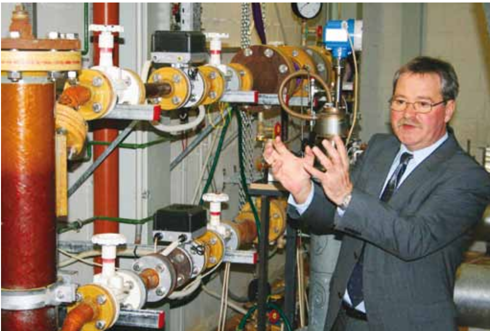
Abb. 31: In der Heizzentrale Neustadt-Glewe
