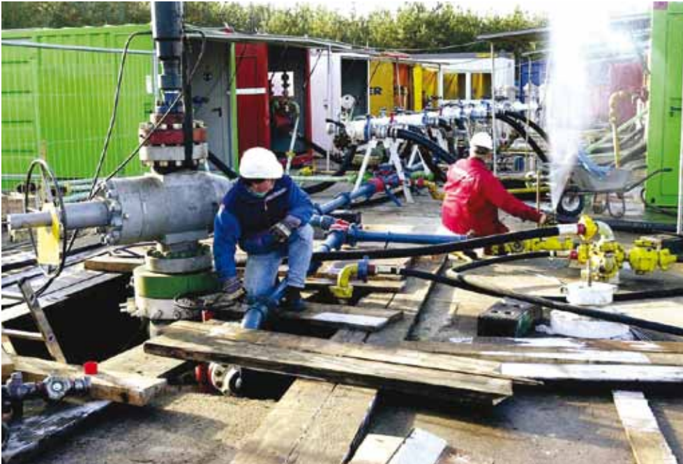
Abb. 15: Pumpenanlage beim Fractest
