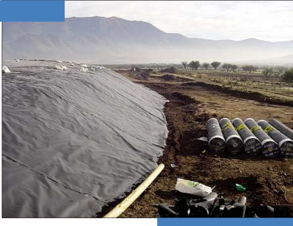
Das Ausbildungsprogramm des Projekts umfasst bereits in der ersten Phase die Vorbereitung und Durchführung von Pilot-sanierungen, wie sie hier mit der Einkapselung einer Deponie, die toxische Abgänge einer Golderaufbereitung enthält, zu sehen ist.
