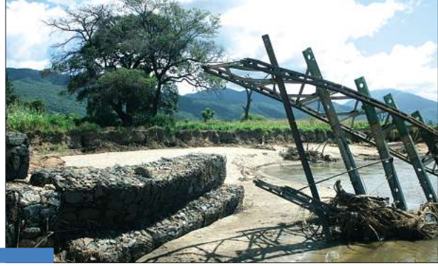
Dwambadzi River: Zerstörte Behelfsbrücke im Jahr 2001.
