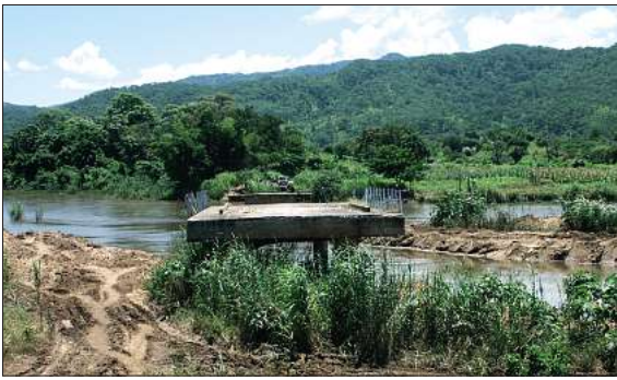
Dwambadzi-River-Brücke: Reste der 1999 weggeschwemmten Brücke.
