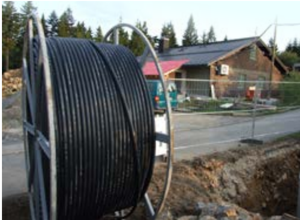
GERES-Zentrale auf dem Sulzberg: Alle Seismometersmessstellen des GERES-Arrays sind über Kabel mit der zentralen Stromversorgung und Datenerfassung in diesem Gebäude verbunden.
